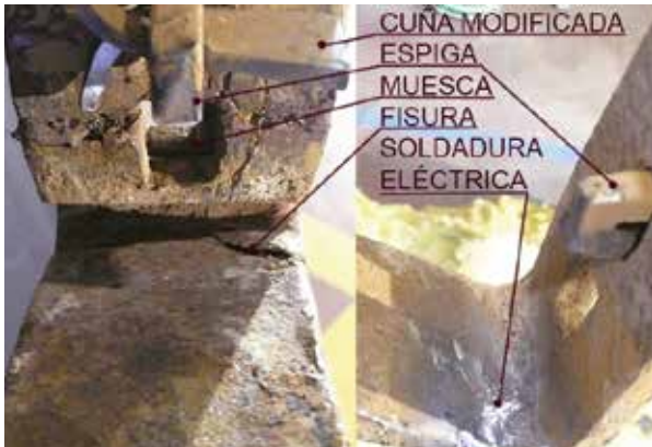
Figura 10. Fisura encontrada en uno de los jabalcone, resultado de la reparación.
