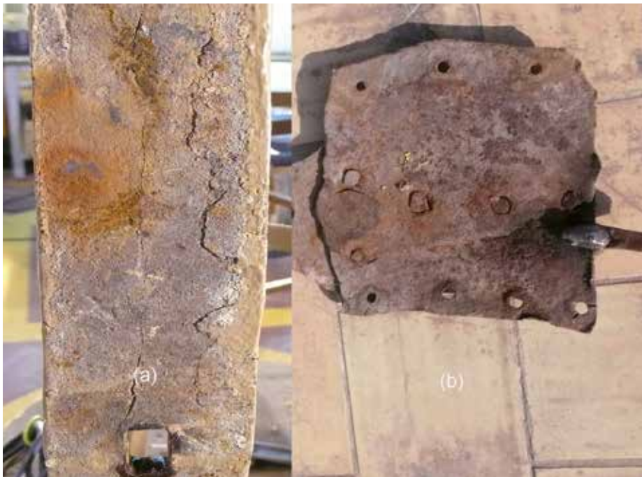
Figura 15. (a) Detalles que muestran las fisuras de los ramales como consecuencia del mal procesado y calidad del acero. (b) Pieza de una repisa.
