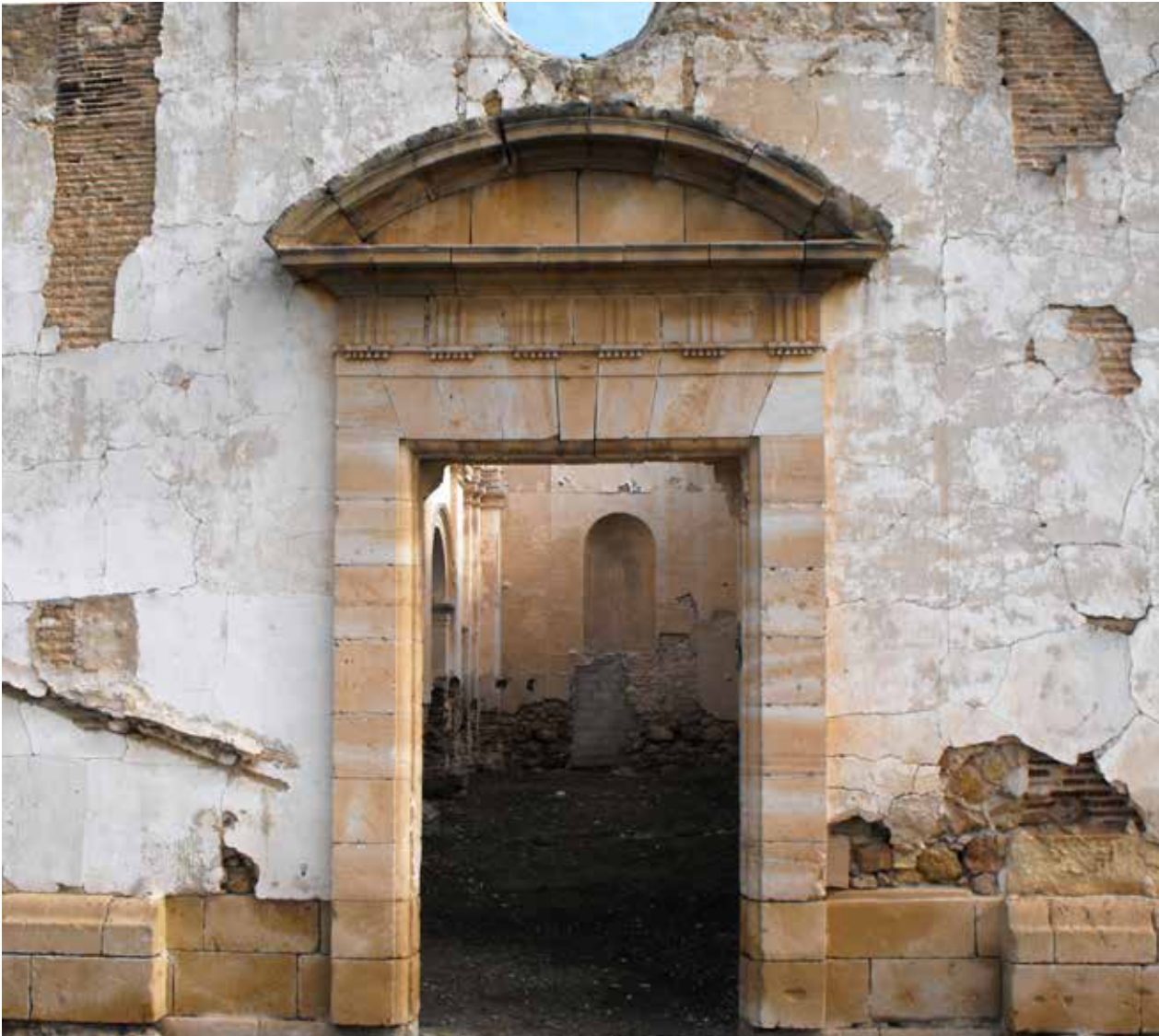
Fachada de la iglesia del antiguo caserío de San Francisco de Asís, en El Molar. / Foto: Rafael McEvoy, Cátedra Pedro Ibarra.
