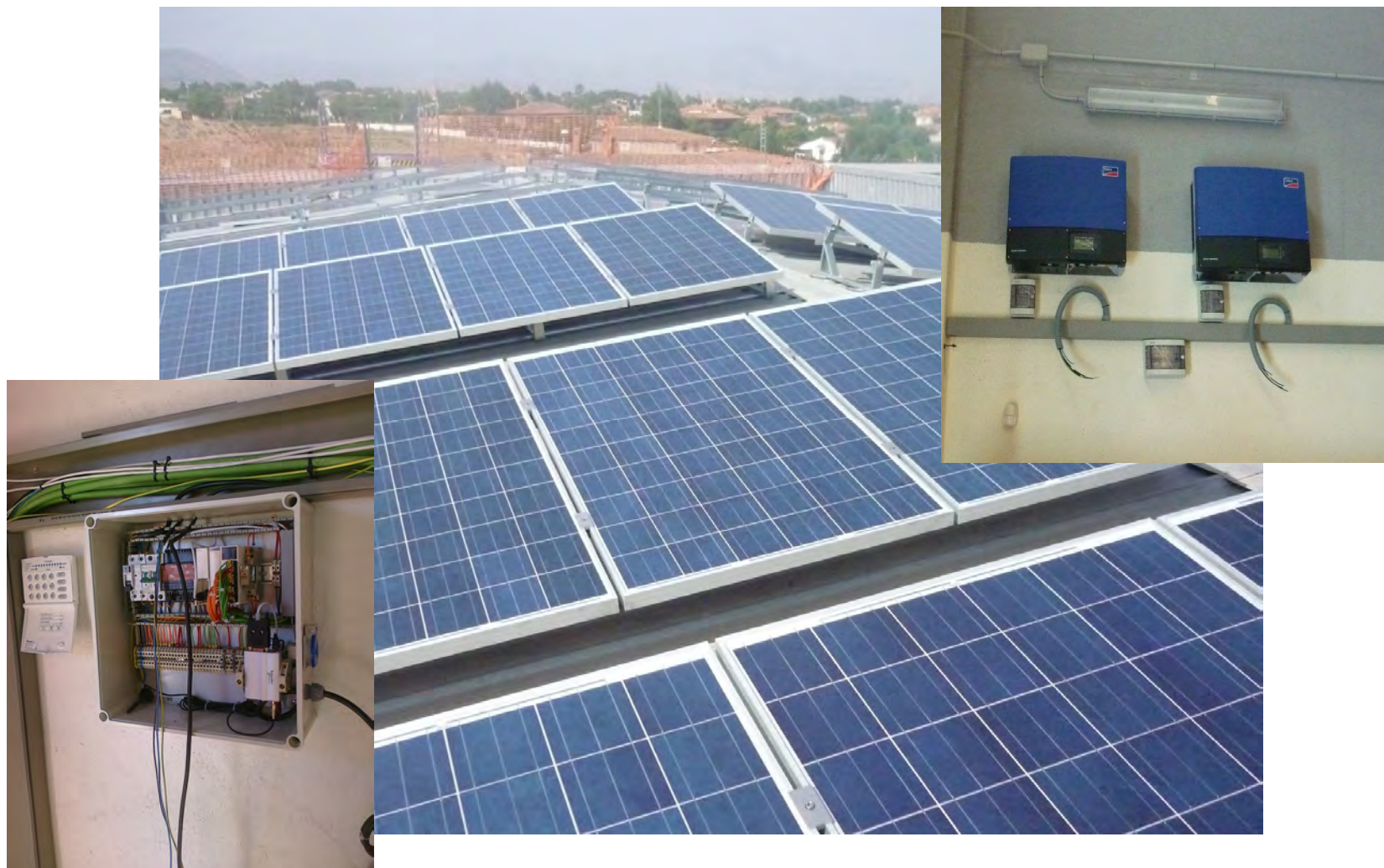
Instalación Venta a Red sobre cubierta R.D. 1578/2008, 20 kW
