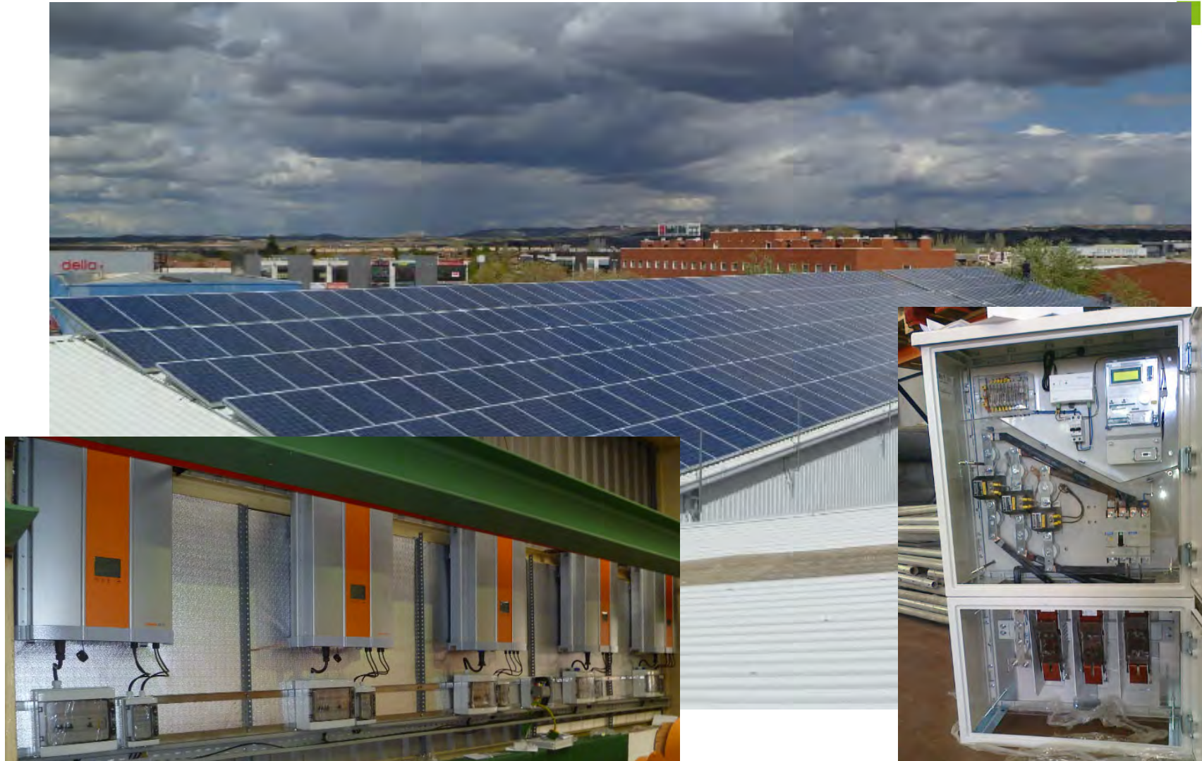
Instalación Venta a Red sobre cubierta R.D. 1578/2008, 80 kW
