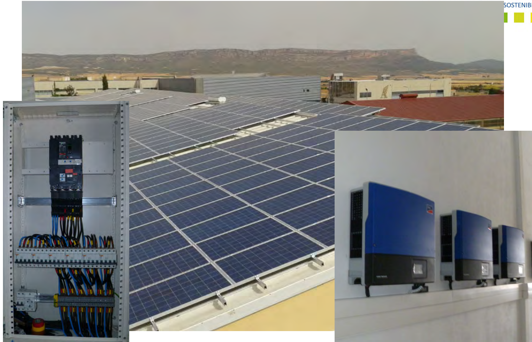
Instalación Venta a Red sobre cubierta R.D. 1578/2008, 100 kW
