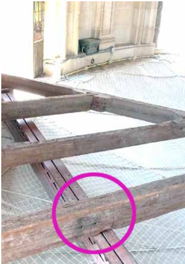
FIGURA 14. Ejemplo de desgaste en una viga de madera. En la parte superior (visible en la parte inferior de la imagen), el cordón superior presenta desgaste por la sujeción de las tablas pertenecientes al piso. En la parte inferior de la viga, el desgaste se debe al roce con la viga de celosía.
